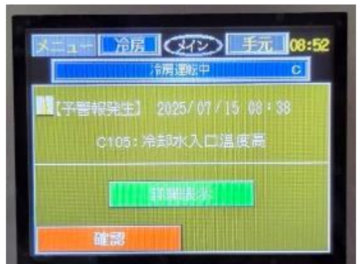
発生機1号の操作画面へ異常表示
