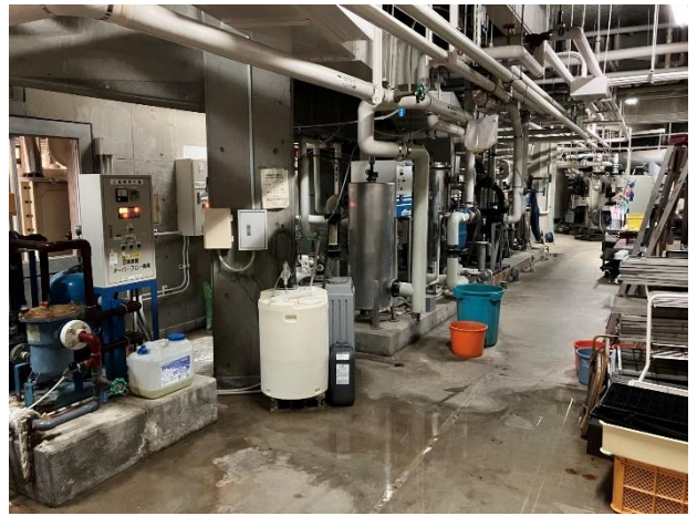
大浴場下機械室
