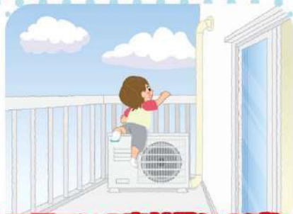
エアコンの室外機にのぼり 手すりを越えて転落
