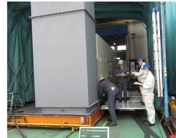
発電機完成 工場写真
