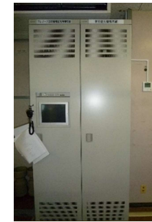
放流警報設備
