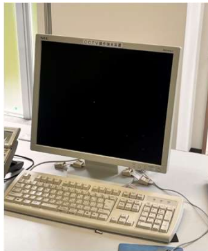
CCTV（監視カメラ）操作端末
