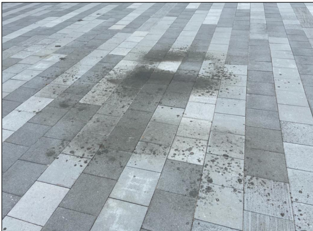
写真-清掃前(舗装の汚損)
