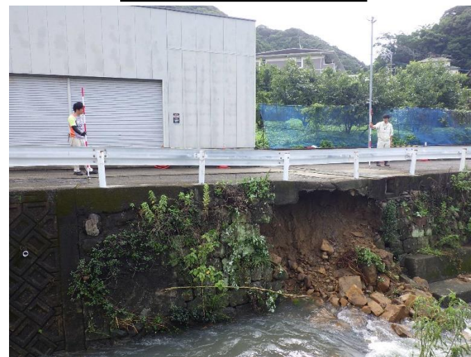
戸石町2号線 被災状況写真
