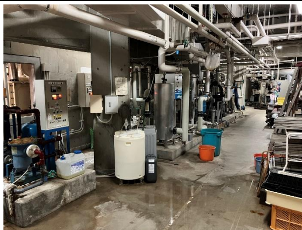
大浴場下機械室
