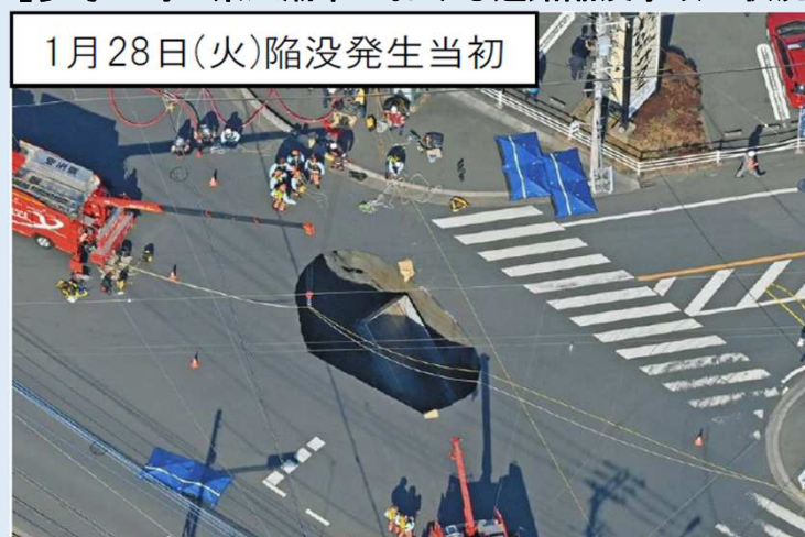
【参考：埼玉県八潮市における道路陥没事故の状況】
