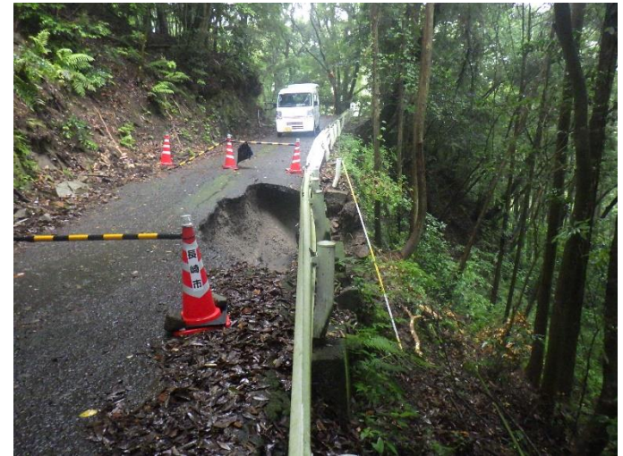
田手原町本河内線 被災状況写真
