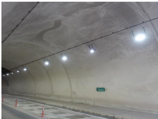
照 明（LED 照明器具）
