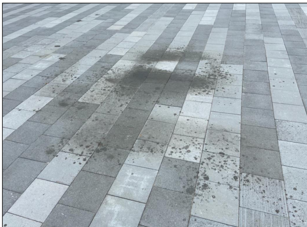
写真-清掃前(舗装の汚損)
