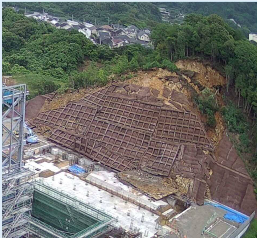
(1) 法面崩落直後 令和6年6月10日時点
