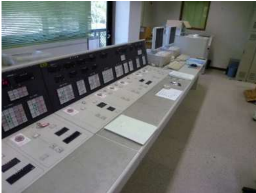
管理用制御処理設備
