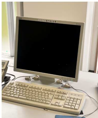
CCTV操作端末
