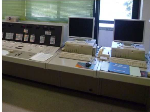
放流警報設備
