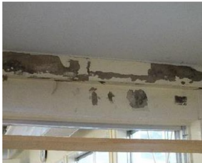
建物内部劣化
