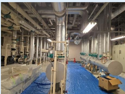
2階熱源機械室
