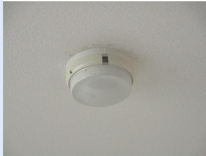
自動火災報知設備（感知器）館内33か所
