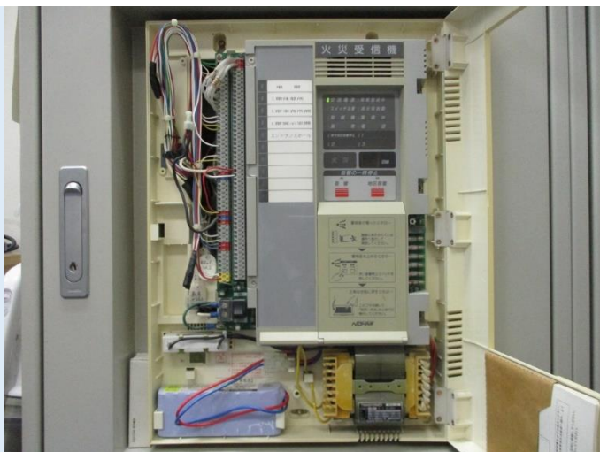
自動火災報知設備（受信機）
