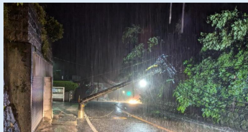
令和6年7月15日大雨・強風時の電柱倒壊(三原)
