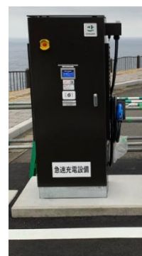
EV 充電設備 （道の駅夕陽が丘そとめ）
