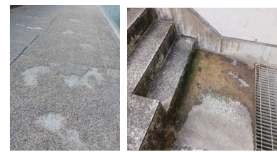
屋外の階段や通路部分 階段にコケが発生し滑りやすい、通路などコンクリート破損による雨漏りのリスク
