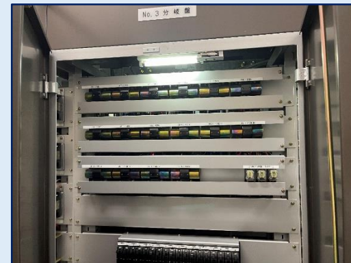
調光分岐盤内部(切替マグネット)
