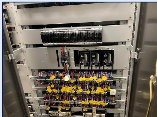
調光分岐盤内部(切替回路)
