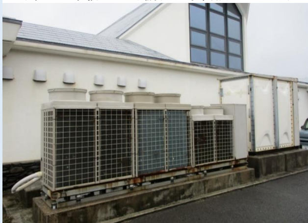
空調設備室外機 (館内三系統の室外機及び氷蓄熱ユニット)
