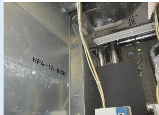
空調設備室内ユニット及びダクト類
