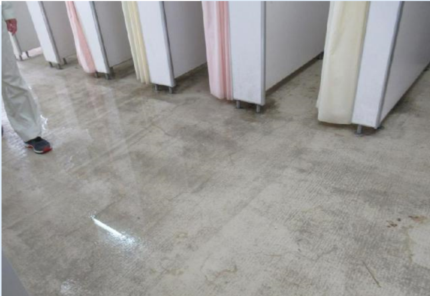
雨水進入の様子(雨天翌日)
