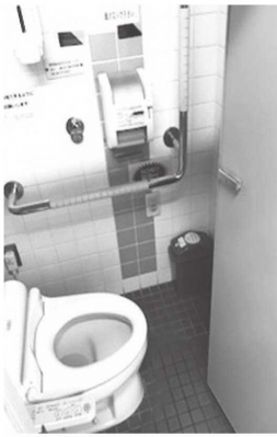
▲もりまちハートセンター の設置状況
