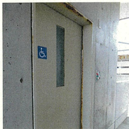
(多目的トイレ扉)
