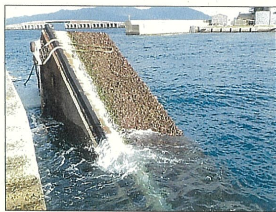
浮棧橋沈没時 写真
