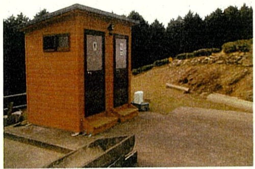
② バイオトイレの設置
