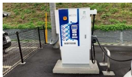
EV 充電設備（長崎のもぎき恐竜パーク）
