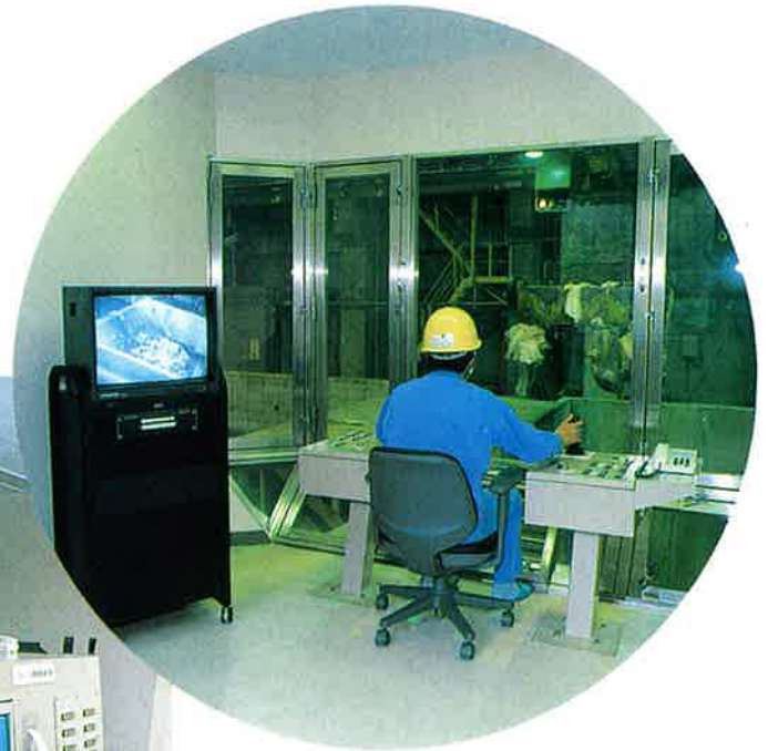
▲ごみクレーン操作室(増設)
