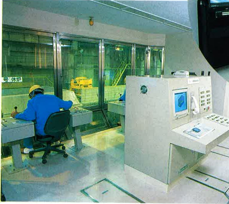
▲ごみクレーン操作室(既設)
