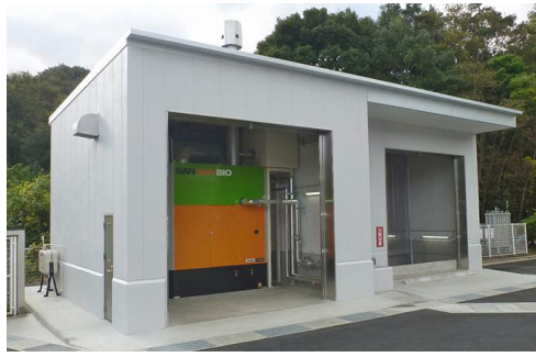
バイオマスボイラー（長崎県西海市遊湯館）（出典：株式会社 三基）
