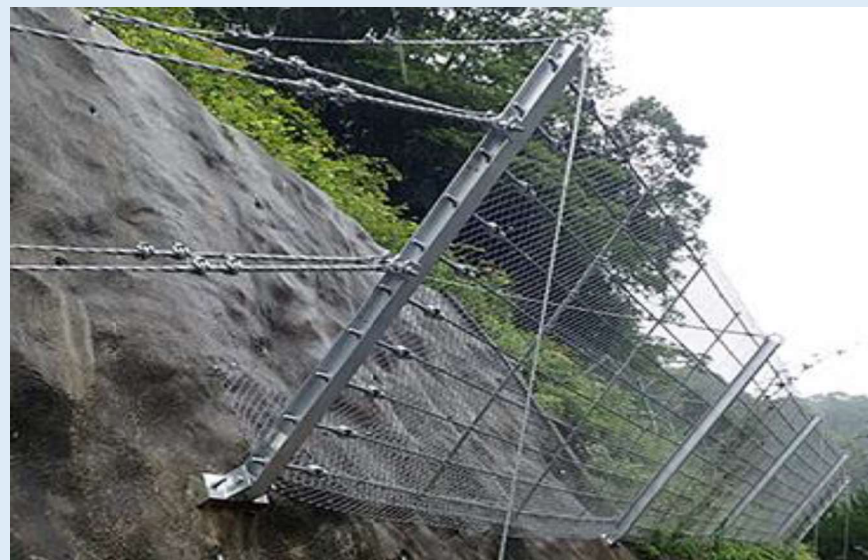
落石防護柵(プラクトフェンス)
