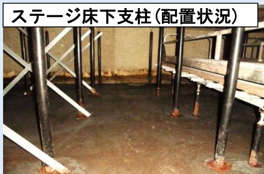
ステージ床下支柱(腐食状況)
