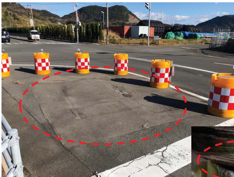
道路改良箇所(陥没)の現況
