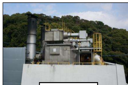
電気集塵装置
