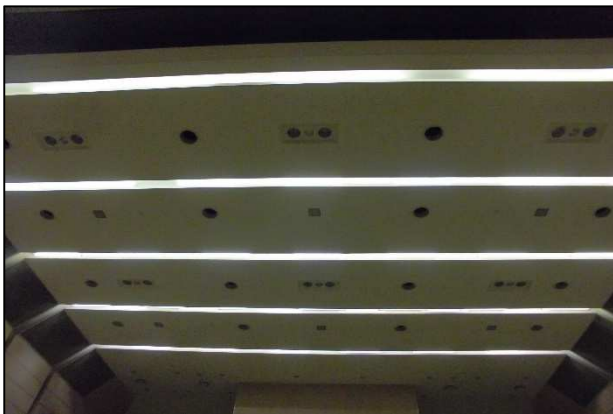
LED施工箇所例 (多目的ホール)
