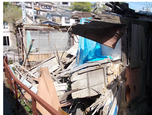
③老朽危険空き家
