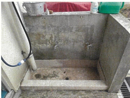
園児足洗場（亀裂・剥離・劣化）
