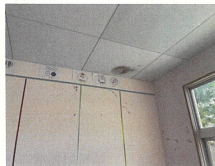
廊下の天井（雨漏り）
