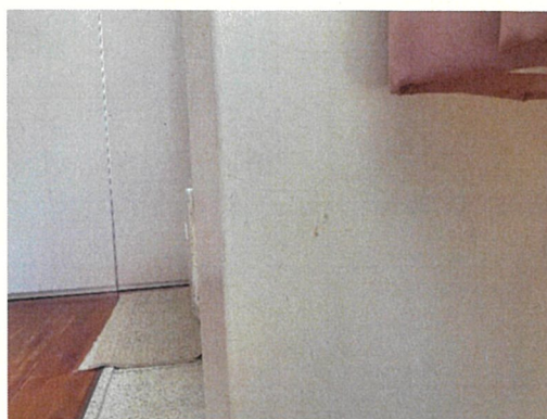
保育室の壁（亀裂）
