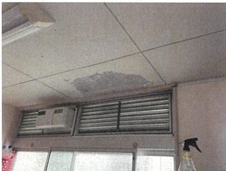
トイレの天井（剥離）
