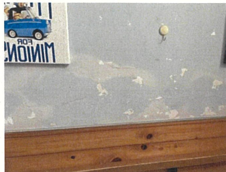
階段の壁（亀裂・塗装剥離）
