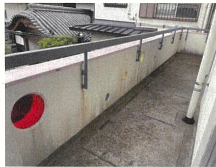
手すり・ベランダの劣化
