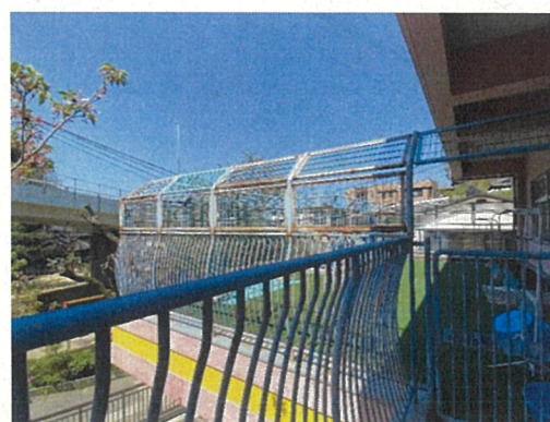
手すり・ベランダの劣化
