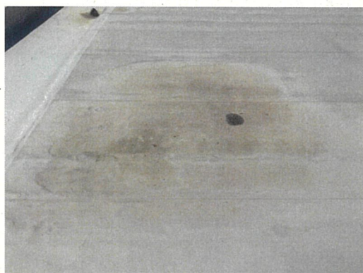
屋上（防水膜劣化）
