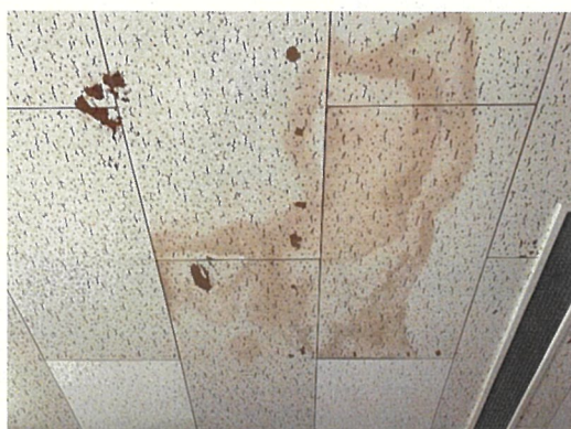
保育室の天井（雨漏り）
