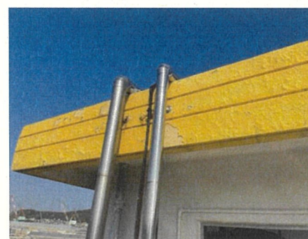
外壁（亀裂・塗装剥離）
