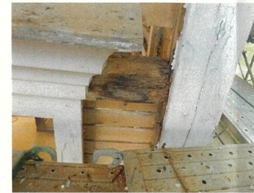
③柱・横架材劣化状況
