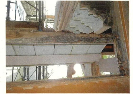
②柱・横架材劣化状況
