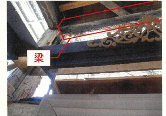
⑤梁劣化状況 (室内から見た梁の劣化状況)
