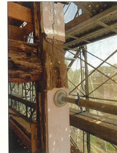
⑥柱劣化状況
