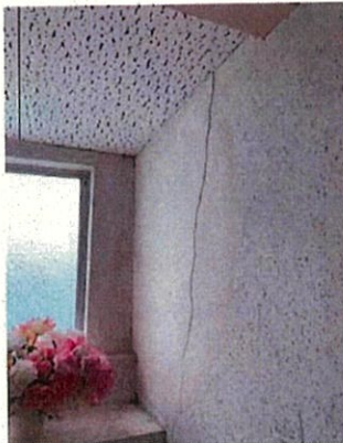
屋内 ひび 摩耗
