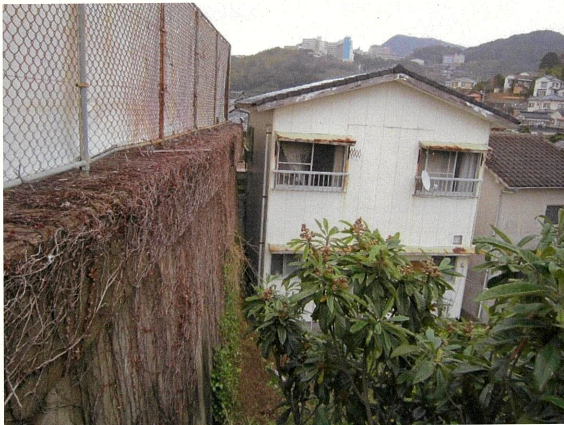
写真③ (南側擁壁と隣接家屋)
