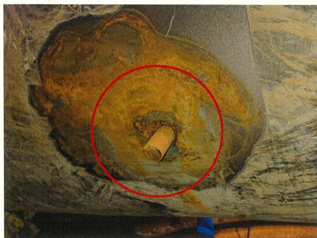
(側部損傷状況)
