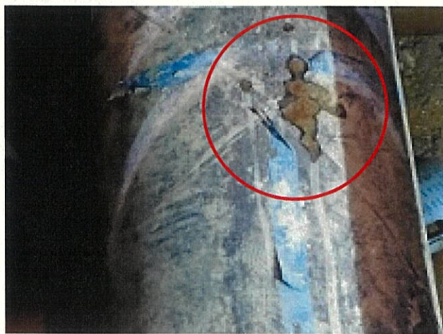
(上部損傷状況)
