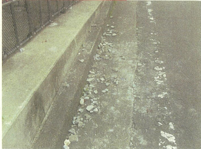
①②(西側道路)落下物
