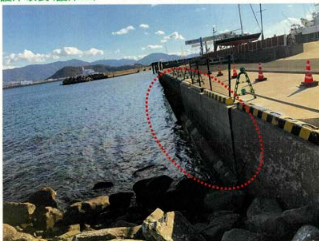
護岸改良箇所の現況(基礎部洗堀による埋土材の流出)
