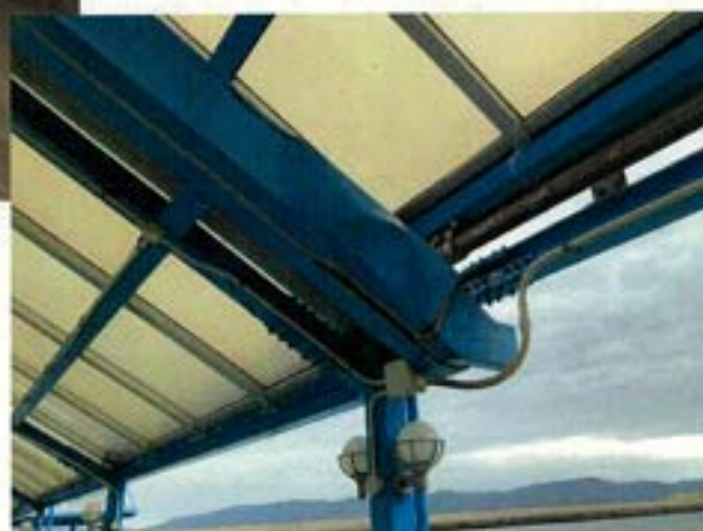
浮棧橋改良箇所の現況(屋根損傷)
