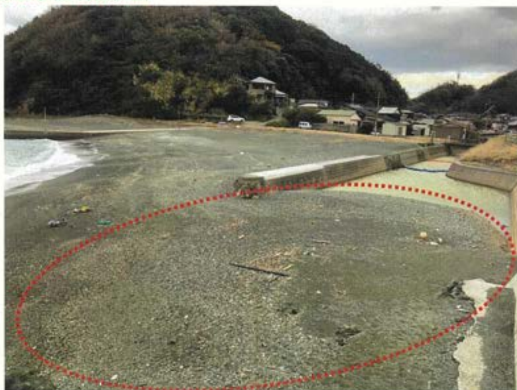
海浜改良箇所の現況(海浜の土砂堆積による河口の閉塞)
