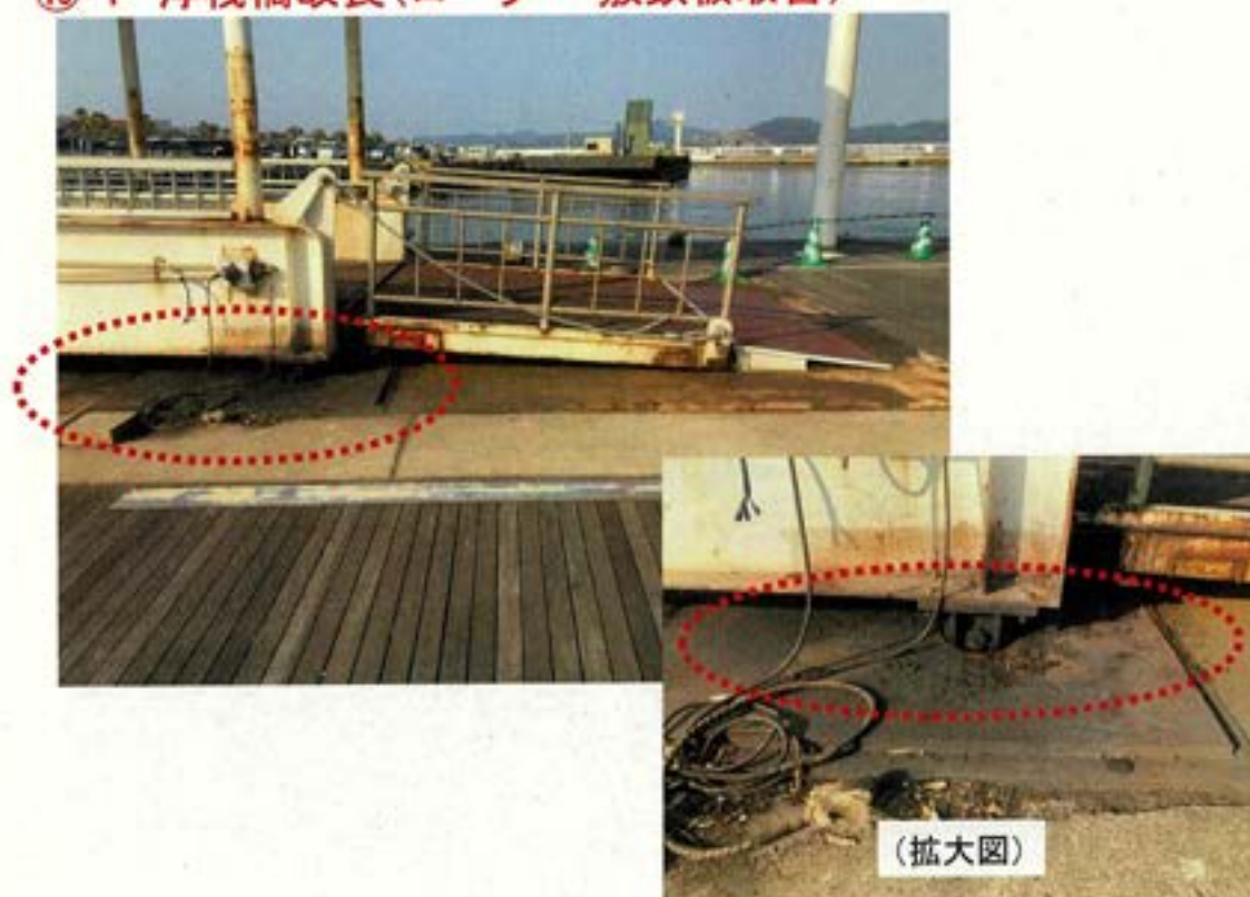
浮棧橋改良箇所の現況(ローラー・敷鉄板の劣化)
