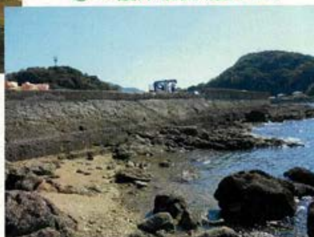
護岸改良箇所の現況(高潮時の背後地の浸水)
