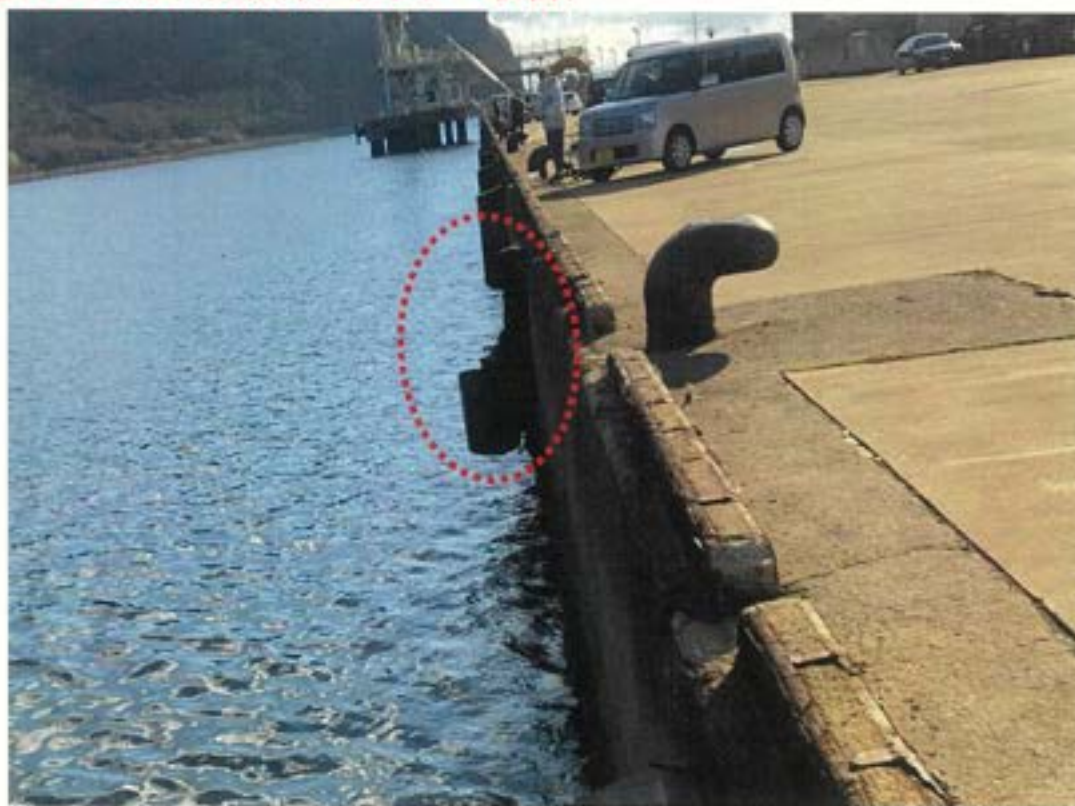
岸壁改良箇所の現況(防舷材の損傷)
