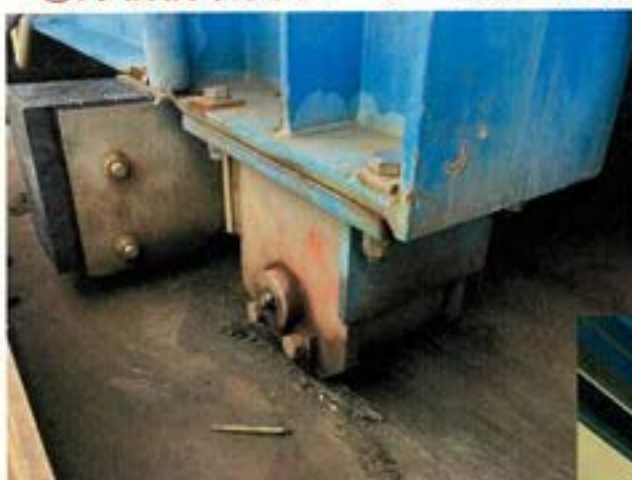
浮棧橋改良箇所の現況(ローラー劣化)
