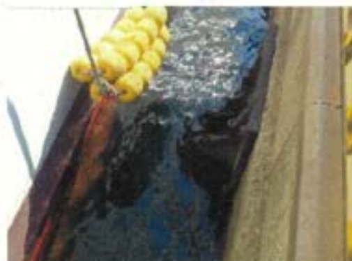
岸壁改良箇所の現況(防舷材劣化状況)
