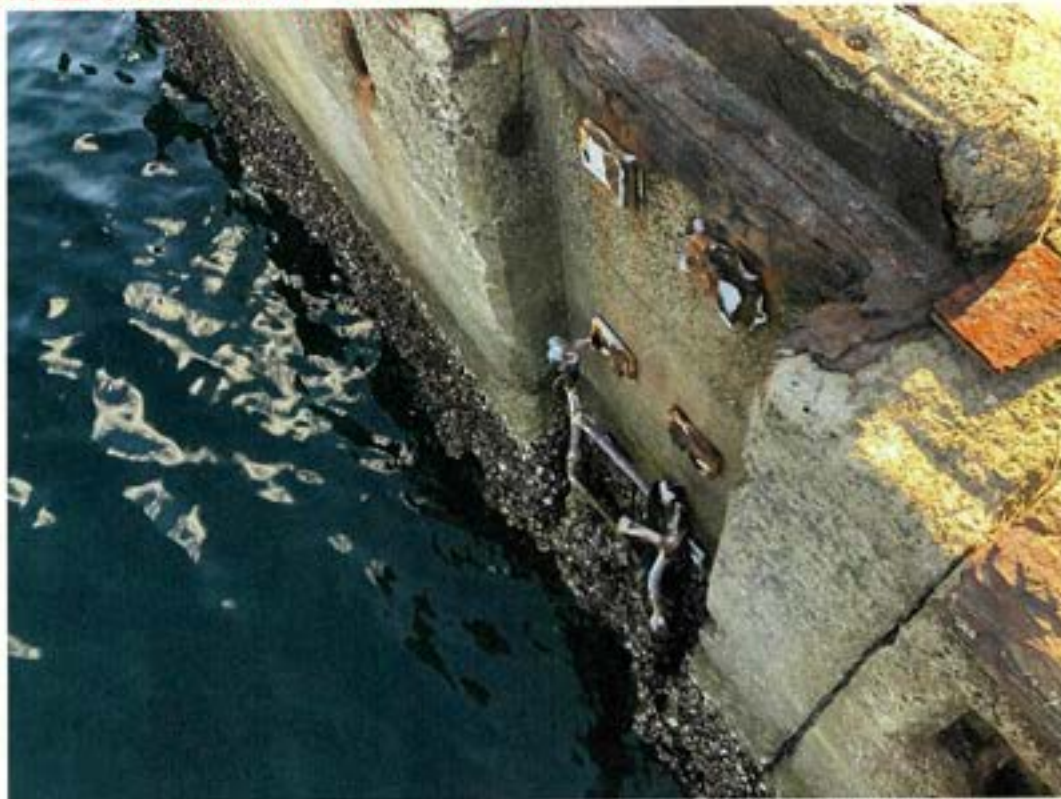
岸壁改良箇所の現況(タラップの腐食・損傷)
