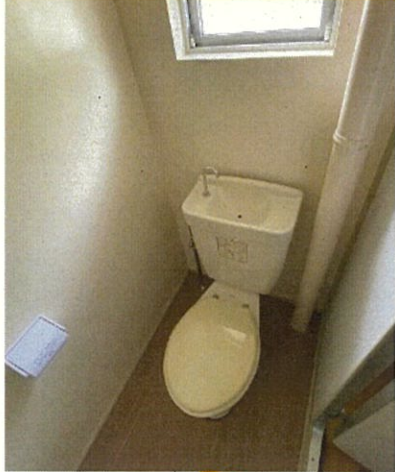
トイレ 使用水量が多い便器
