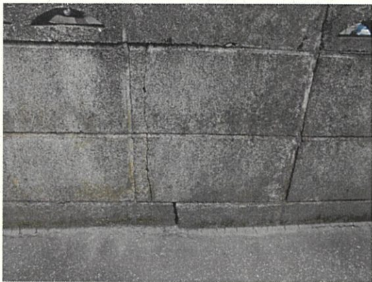
・ひびが入ったブロック塀
