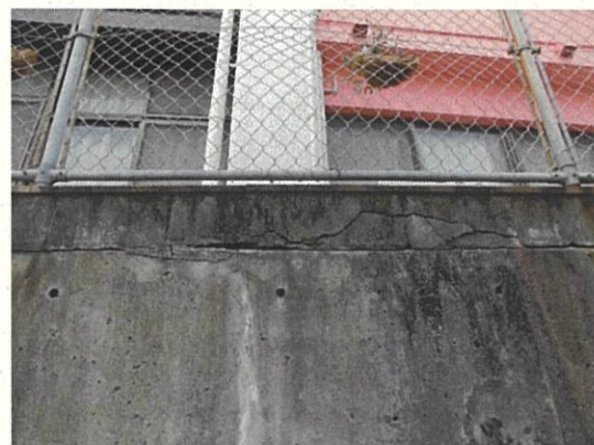
・ひびが入ったフェンス下のコンクリート
