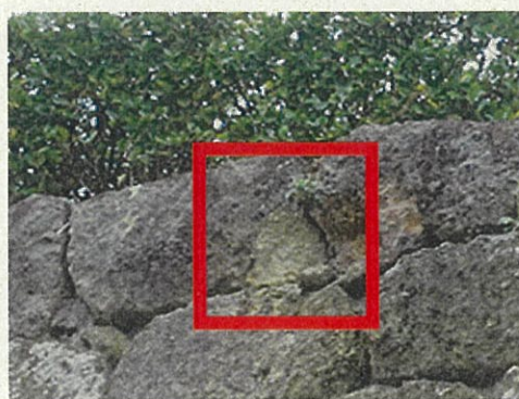
劣化箇所の例
