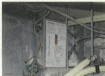
【室内ユニット(天井内)】
