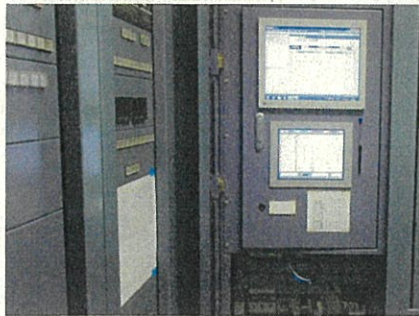
【中央監視装置盤】
