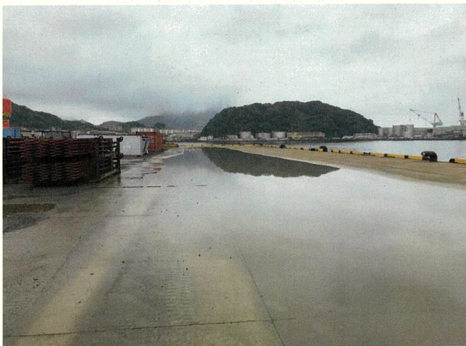
岸壁の沈下状況
