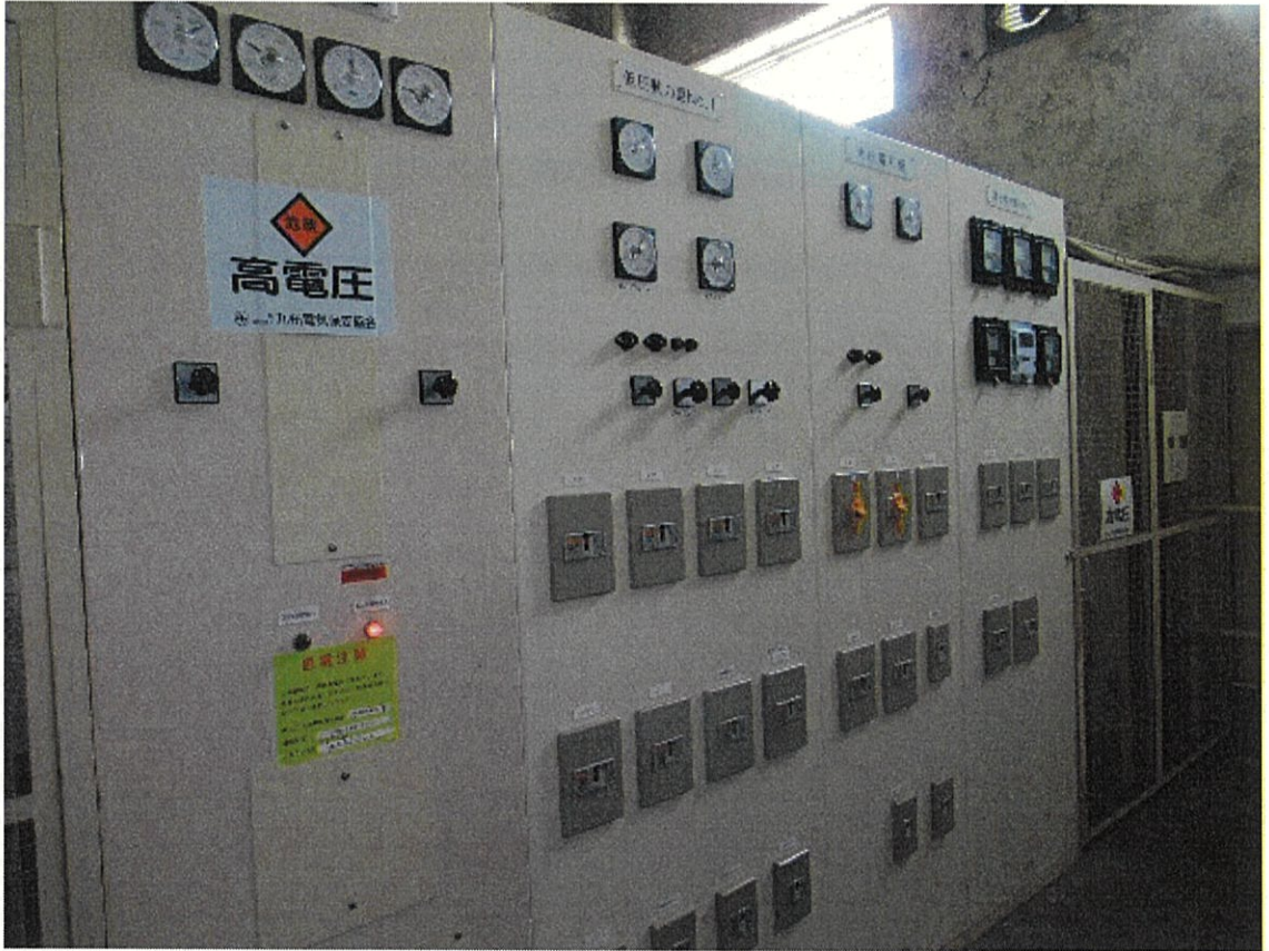
(高圧受変電設備操作盤面)
