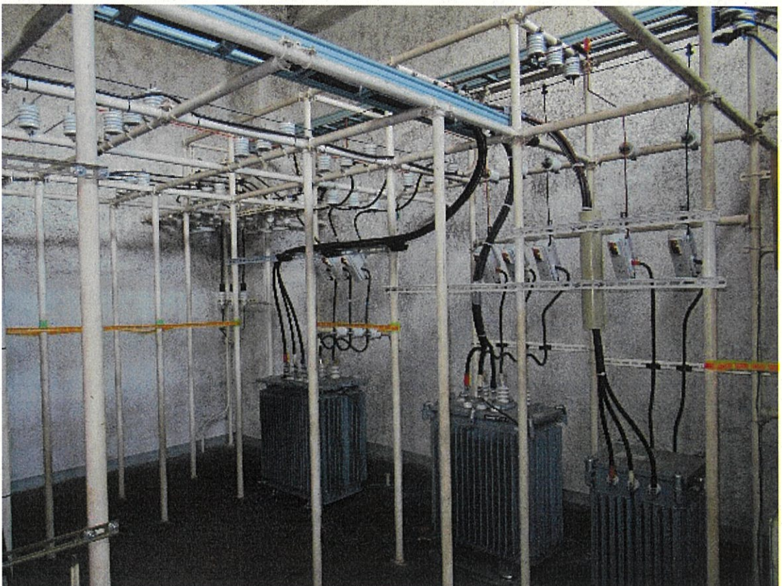
(高圧受変電設備内部)
