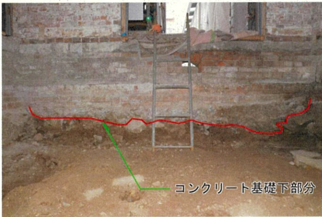
職員住宅煉瓦棟基礎下不足状況
