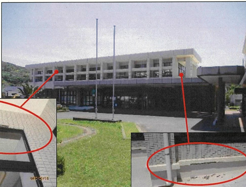
外壁改修（全体的に劣化）
