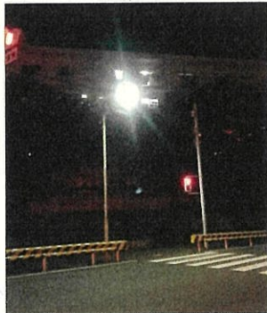
道路照明灯(2,739灯) 〈水銀灯〉
