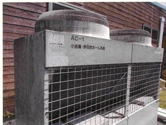
(既存空調 室外機)
