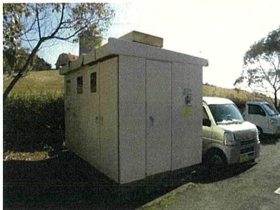
第2 受電設備外観
