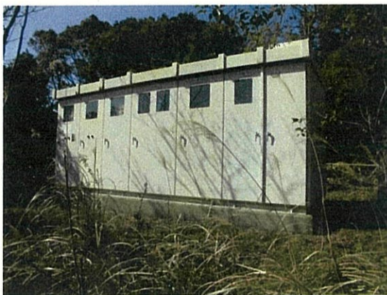
第1 受電設備外観
