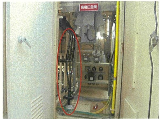
第1 受電設備内部
