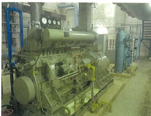
自家発電設備状況写真
