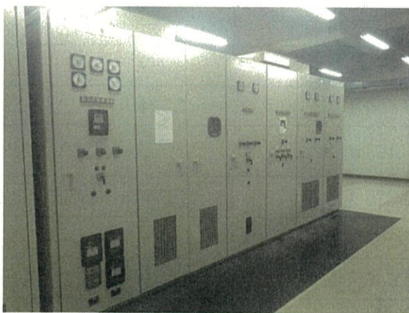
受変電設備状況写真
